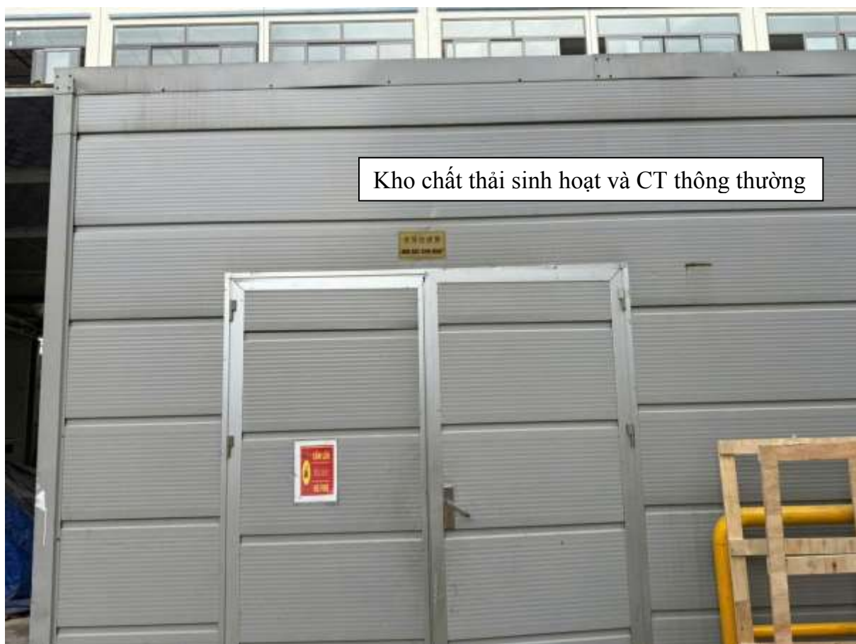
Hình 3.12. Kho chứa chất thải của nhà máy
