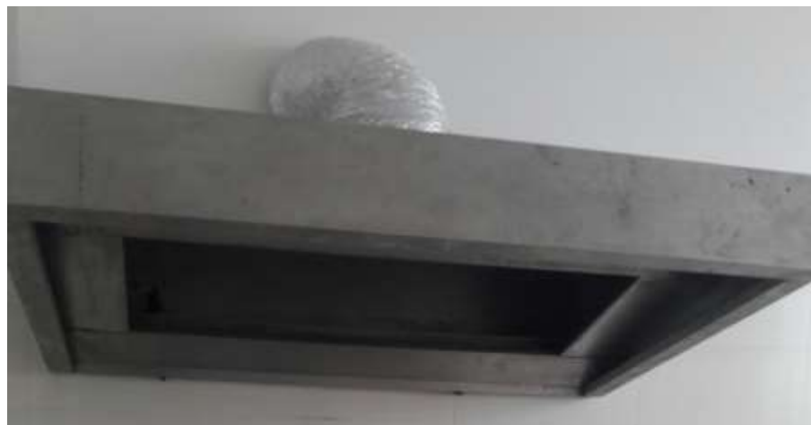
Hình 3.11. Chụp hút hệ thống xử lý khói bếp
