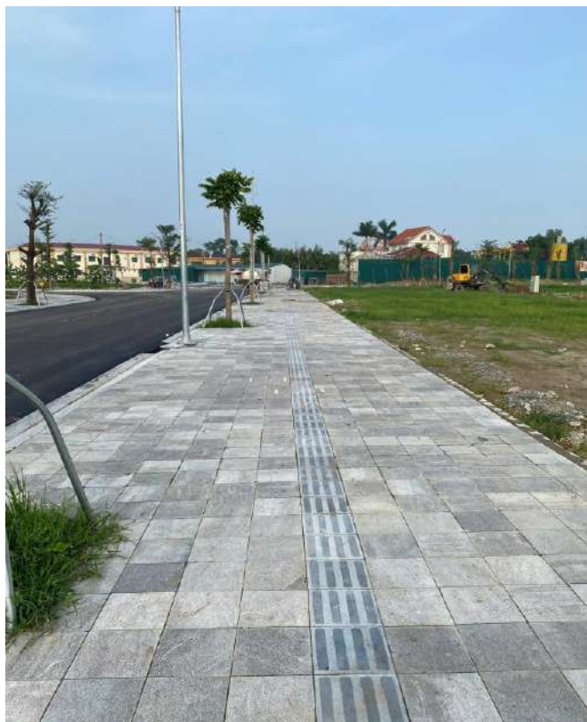
Hệ thống rãnh thoát nước thải xây ngầm vỉa hè
