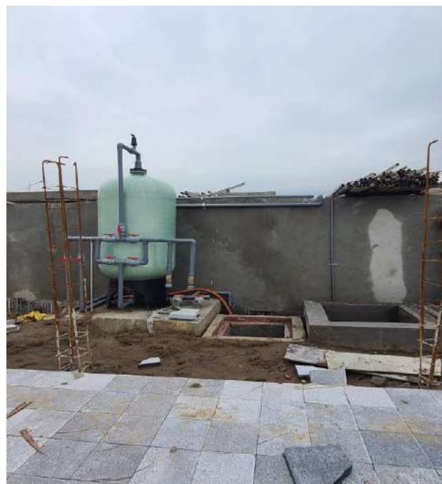
Hệ thống bơm lọc áp lực HTXL nước thải
