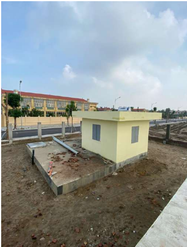
Bể cứu hoả và nhà bơm nước
