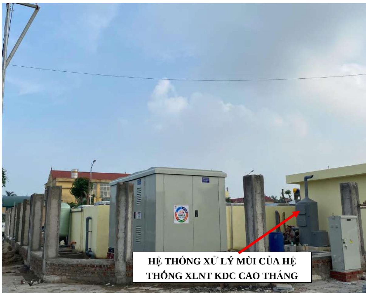
Hệ thống xử lý mùi hôi từ trạm xử lý nước thải đã lắp đặt
