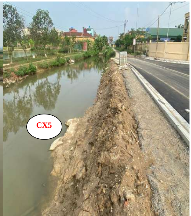
Cửa xả nước mưa CX5
