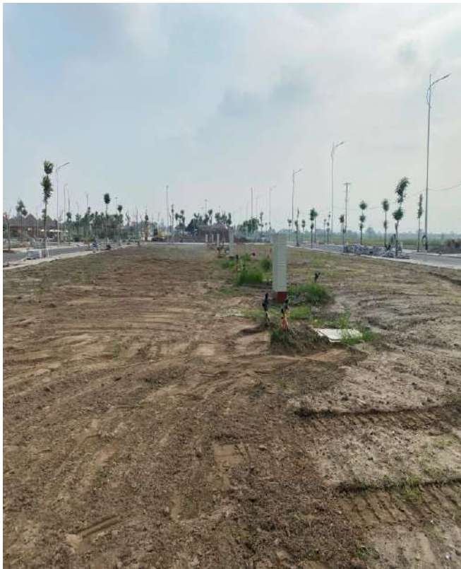
Hệ thống cấp điện, thông tin liên lạc lô liền kề
