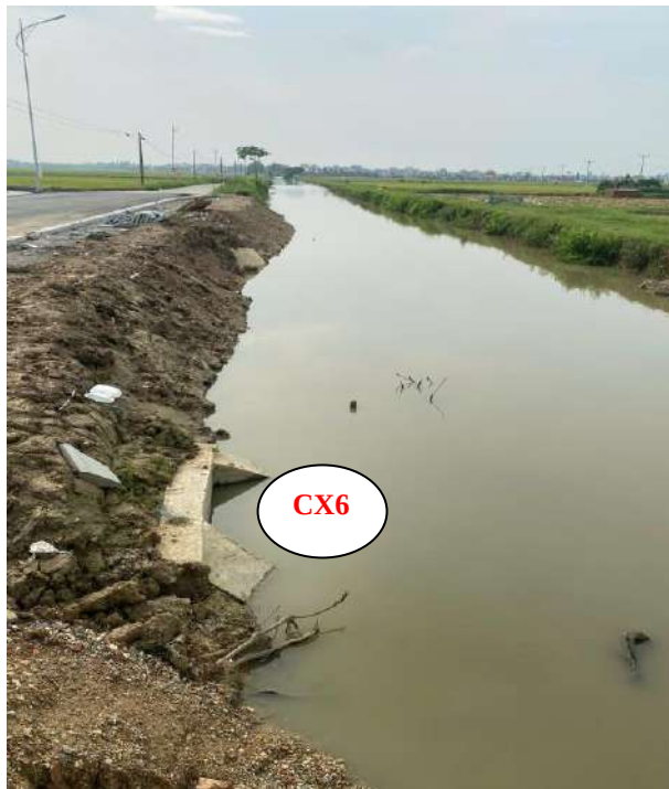
Cửa xả nước mưa CX6
