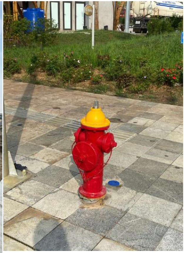
Trụ nước cứu hoả dự án
